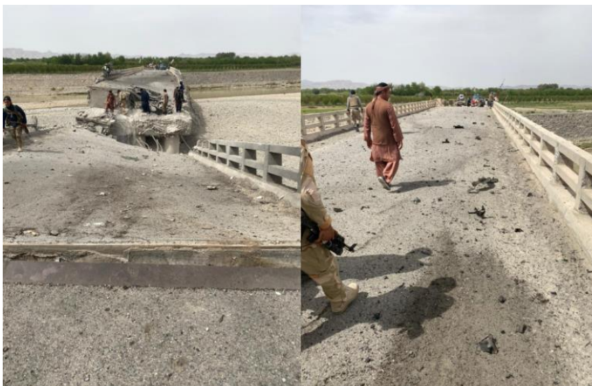
شکل 1: تخریب یک پل بزرگ در ارغنداب توسط گروه مزدور و جاهل طالبان به تاریخ چهارم حمل سال 1400 در ولسوالی ارغنداب. تصویر: از هشت صبح. https://8am.af/kandahar-police-taliban-bomb-a-large-bridge-in-arghandab-district
